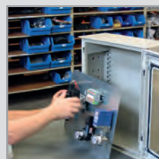
Montage d'armoires prêtes à monter
